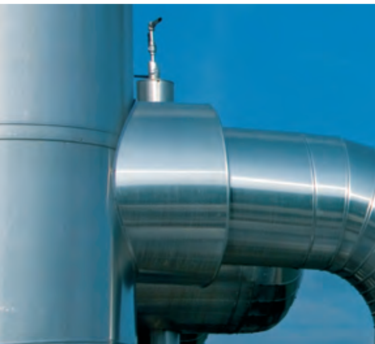
Bagnore (Grosseto) • Centrale geotermica del Monte Amiata
