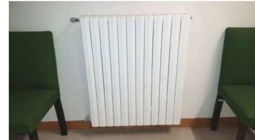
Terminali di emissione per il riscaldamento
