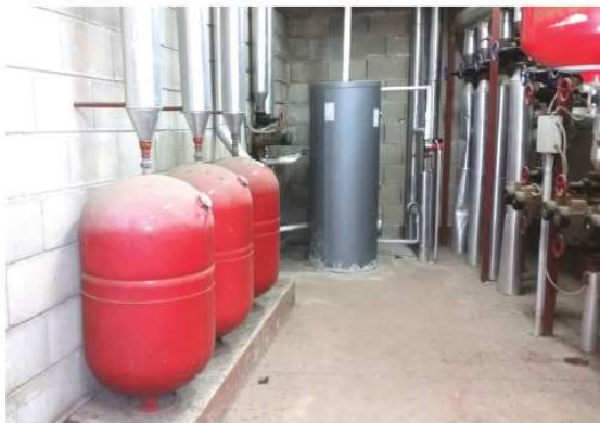
Boiler per ACS
