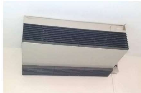
Terminali di emissione per il raffrescamento
